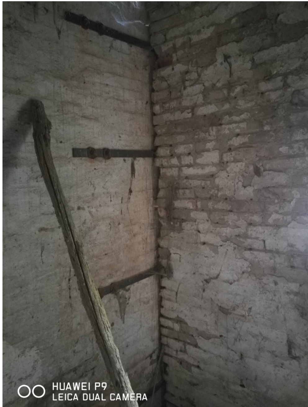
Particolari di precedenti interventi di consolidamento del basso servizio con angolari metallici e catene
