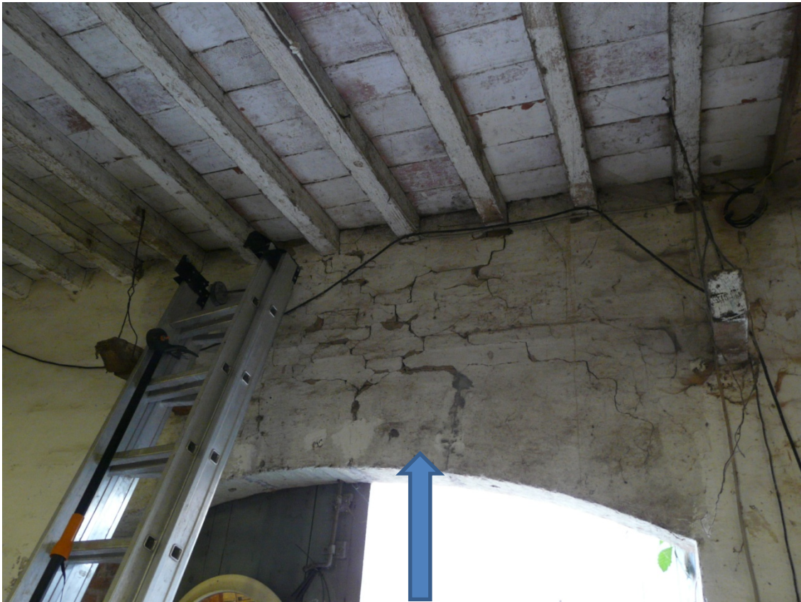
Lesioni sulla volta del portone di accesso.
